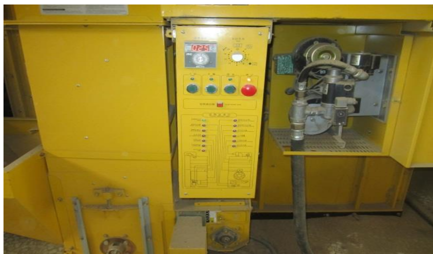
شکل ۳- مشعل گازی و تابلوی کنترل عملیات دستگاه خشک کن ایستاده گردشی
