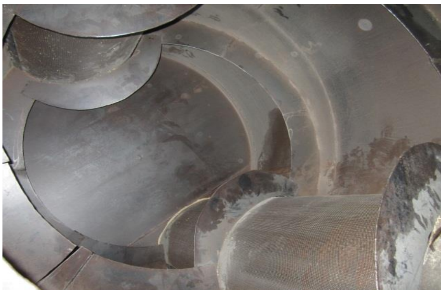
شکل ۹- ماریچ‌های داخل دستگاه خشک‌کن دوار برای انتقال شلتوک
